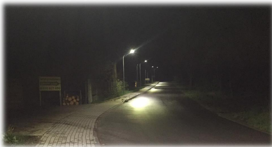
Widok oświetlenia ulicznego przy tartaku
